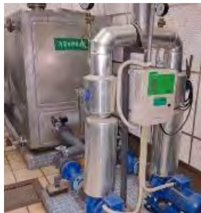
冷凝水回收箱
