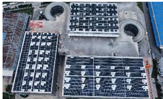
万纬武汉东西湖冷链园区屋顶光伏
