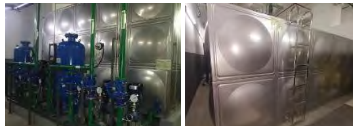
雨水回收装置
