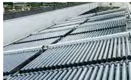
三亚瞻云精选酒店光伏铺设
